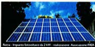
Roma - Impianto fotovoltaico di 2 kW - realizzazione: Associazione PRA
